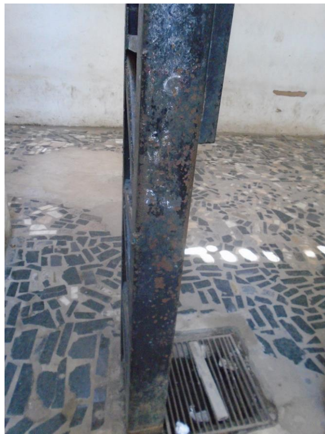
Imagem 26 – Imagem do pilar enferrujado. Fonte: COPROJ-SEINF.
