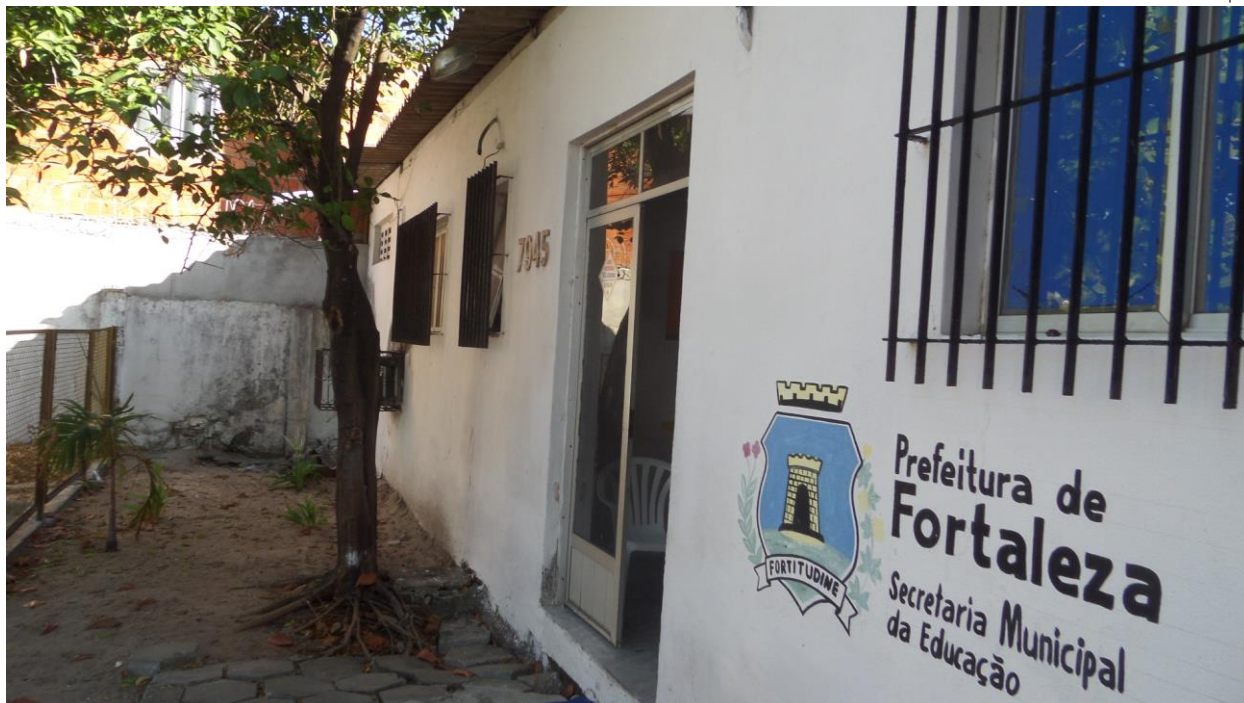
Imagem 04 – Foto tirada in loco do desnível para entrar na porta da escola. Fonte: COPROJ- SEINF.
