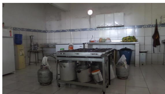
Figura 5 e 6 – Quadro de Energia e Cozinha
