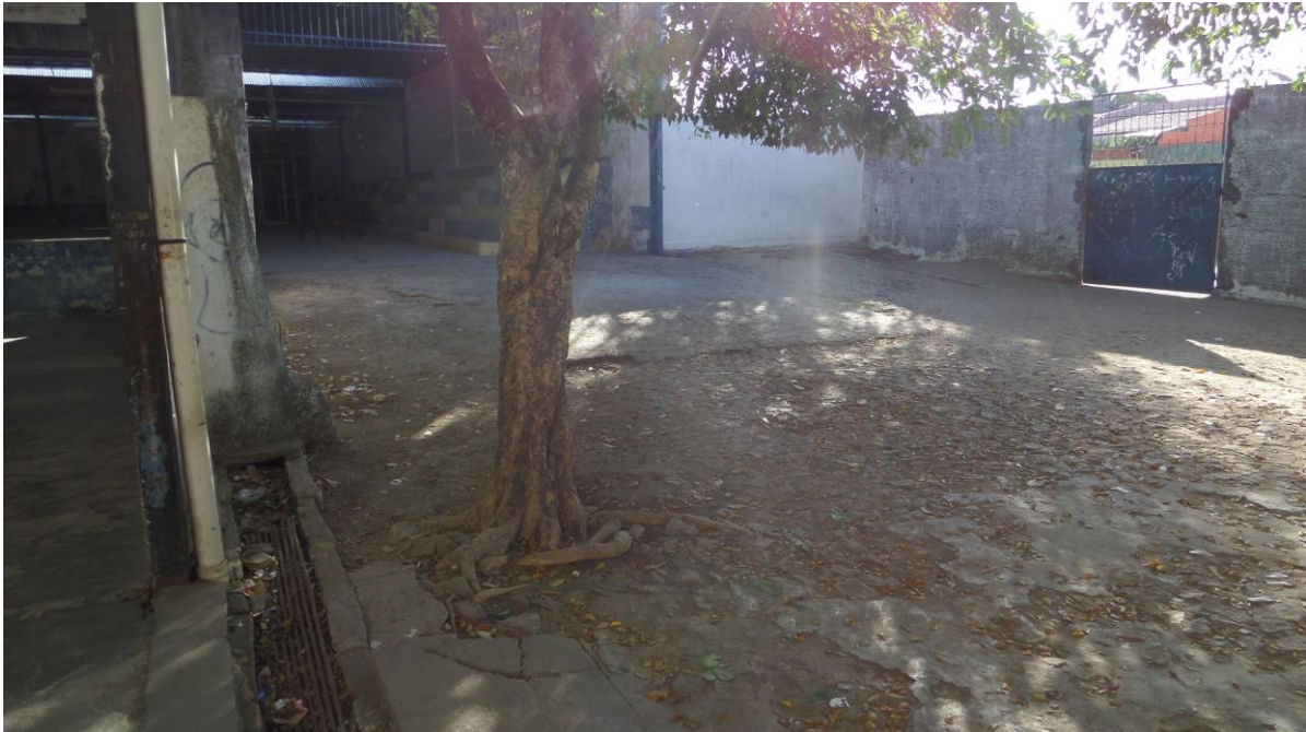
Imagem 05 – Foto tirada in loco da rampa de acesso às quadras com inclinação inadequada. Fonte: COPROJ-SEINF.
