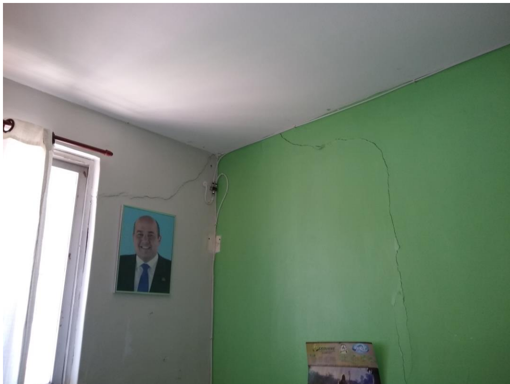
Imagem 12 – Foto tirada in loco da rachadura na sala da direção. Fonte: COPROJ-SEINF.
