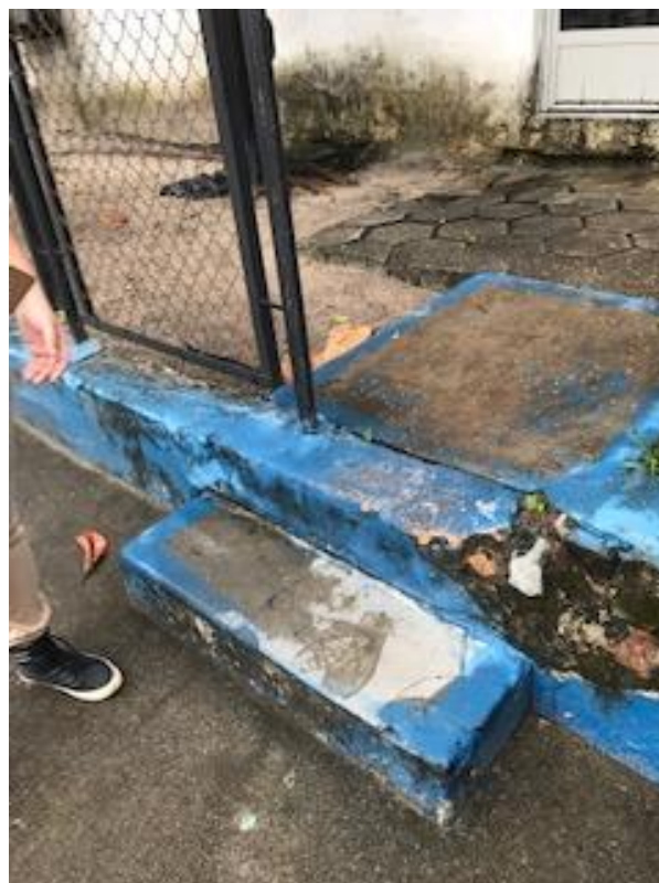
Imagem 03 – Foto tirada in loco dos degraus da escada na entrada da escola. Fonte: COPROJ- SEINF.
